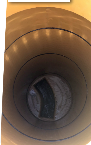
REGARD K-LI'EAU 100% REVÊTU
